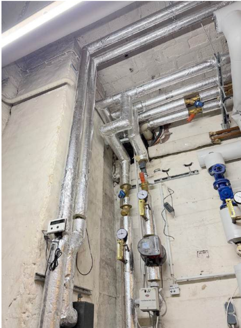
Erweitere hydraulische Unterverteilung unter dem Kirchraum
