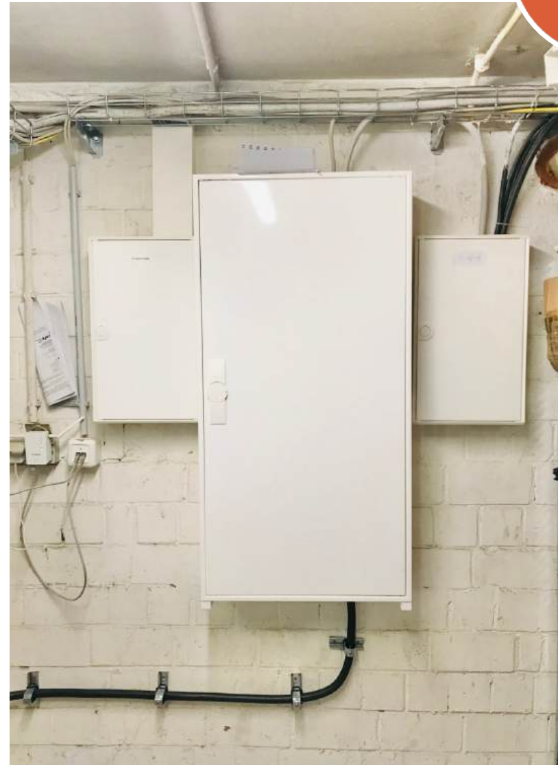
Neuer Stromanschluss für die Luftwärmepumpen
